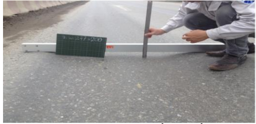
Hình 4.4: Lún VBX lớp BTN thực tế trên tuyến QL1 [16]
