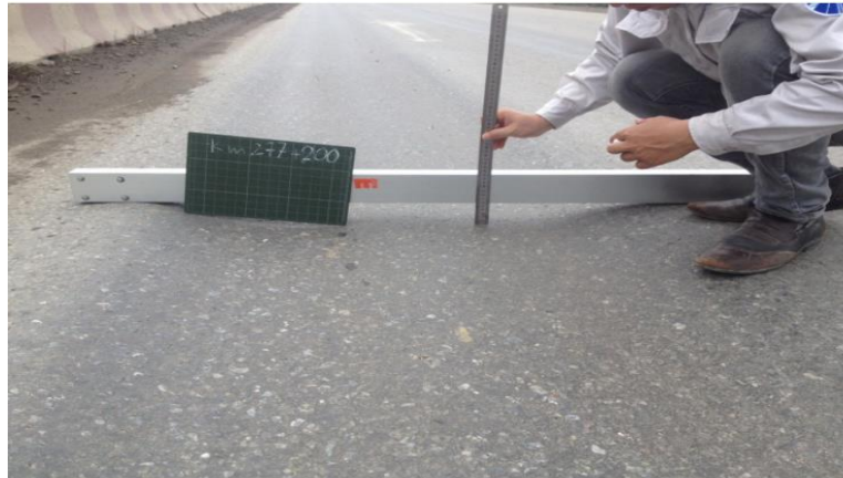
Hình 4.4: LVBX lớp BTN thực tế trên tuyến QL1 [16] đoạn qua tỉnh Hà Nam – Thanh hóa (ảnh chụp năm 2012)
